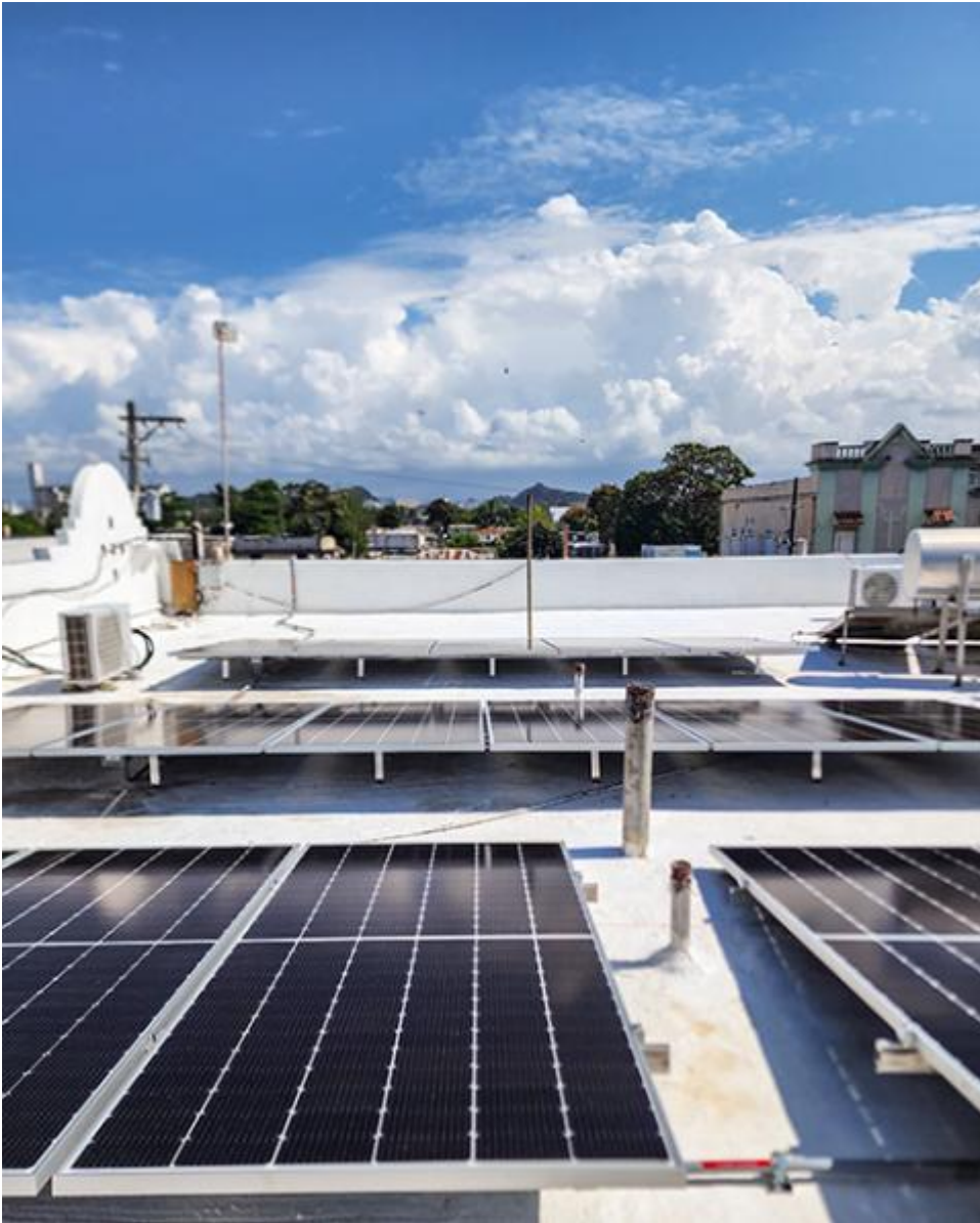
The new rooftop solar array at Nuestra Señora del Carmen in Cataño, Puerto Rico (Courtesy of Lissette A. Avilés-Ríos)
